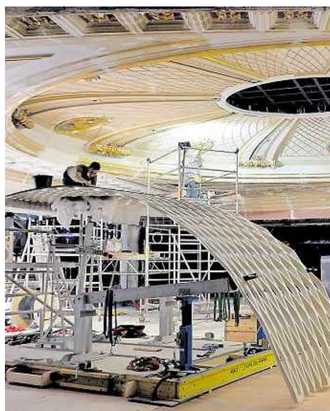
Die Unvollendete. Auf Berlins zweitgrößter Problembaustelle, der Staatsoper, gibt es bis zur offiziellen Übergabe im kommenden Frühjahr noch viel zu tun. Im Bild: Die Kuppel des großen Saales wird mit einer Nachhallgalerie ausgerüstet.
